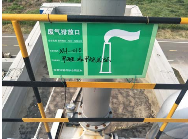
图 8.3-2 废气排气筒现场照片
