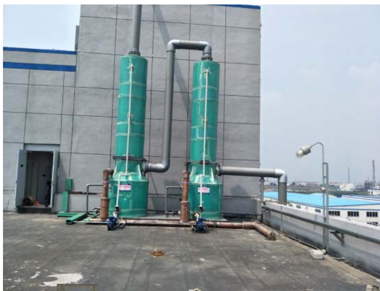
图 4.1-1 两级喷淋塔及排气筒实景照片
